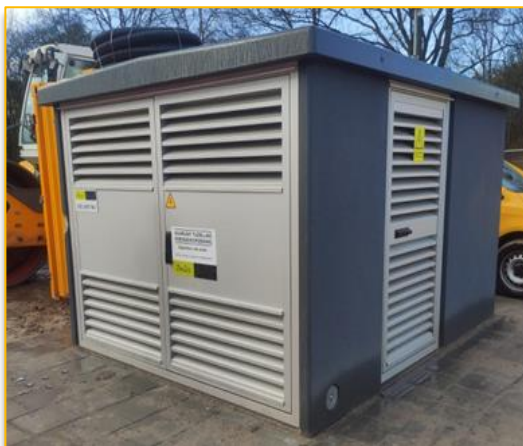
Laden met stroompunt
